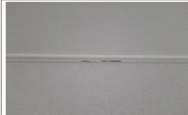
e) 석고보드면의 몰딩 부위 균열로 인한 내부 수성 도장면 벗겨짐 생활하자
