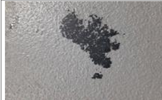
c) 주차장 바닥 부위 이물질 오염으로 인한 생활하자
