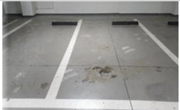
f) 주차장 바닥 이물질로 인한 도장면 생활하자
